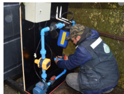
LOS SISTEMAS CUENTAN CON UN CLORADOR PARA DESINFECTAR EL AGUA
